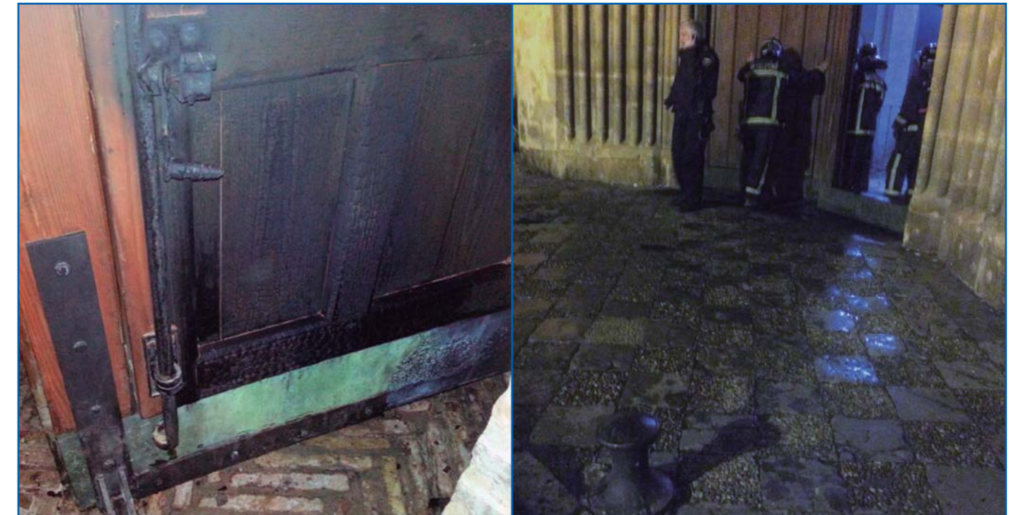
Algunos de los daños materiales que el fuego provocó en la puerta principal de Santa Marina. / Miguel Ángel Pérez y Rosa González.
